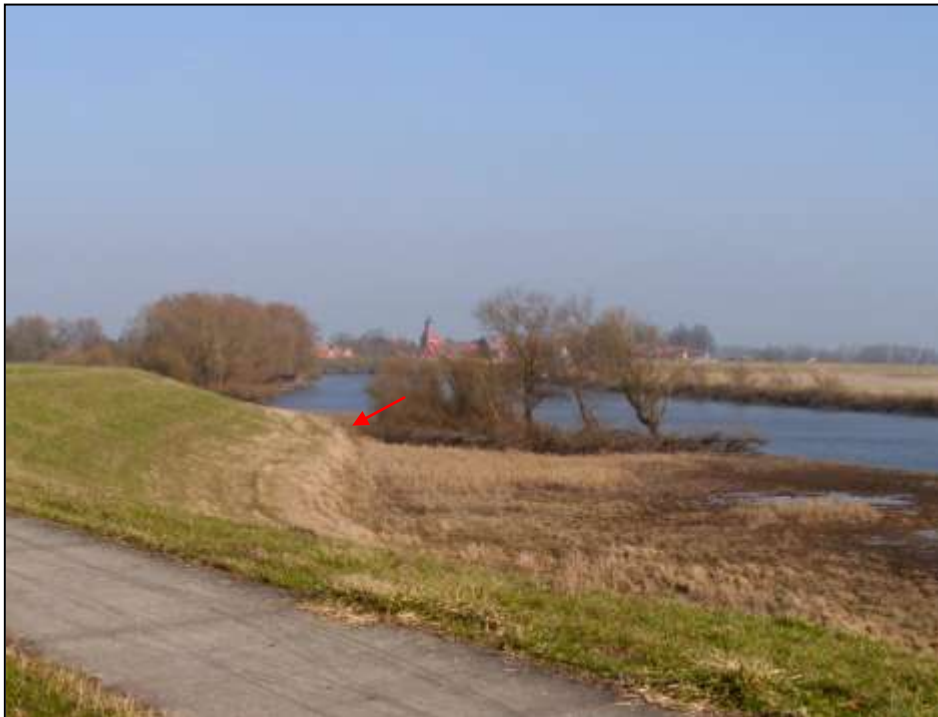
Abb. 9: ein zu nah am Wasser befindlicher, vom Unterwühlen durch Biber gefährdeter Deich (der Pfeil verweist auf einen besonders kritischen Bereich). Foto: A. Weber
